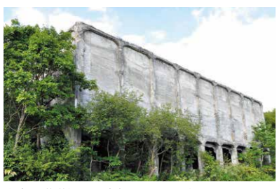
山奥の道道沿いに突如現れる、巨大なコンクリートの遺構。その大きさと迫力は羽幌炭鉱のホッパー跡にも引けを取らない。
